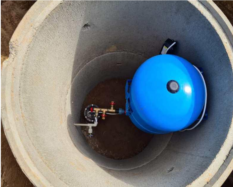
Приклад облаштування колодязя над свердловиною (мембранний напірний бак в колодязі)
